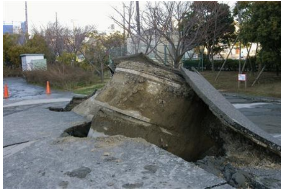
Les conséquences de la liquéfaction des sols dans un logement collectif d'Urayasu (mars 2011)
